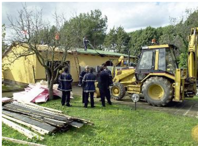
Il località Campotatti il comune di Poggibonsi ha fatto demolire alcune strutture
